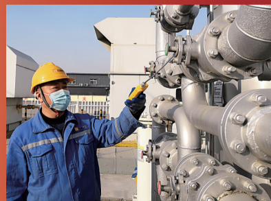
加气站运行工穆金良: 确保加气设备安全运行
