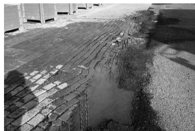
地址: 新华路鼓楼广场附近 非机动车道边地砖碎裂, 地面还常有积水, 给过往市民通行带来不便。 赵华堂 摄
