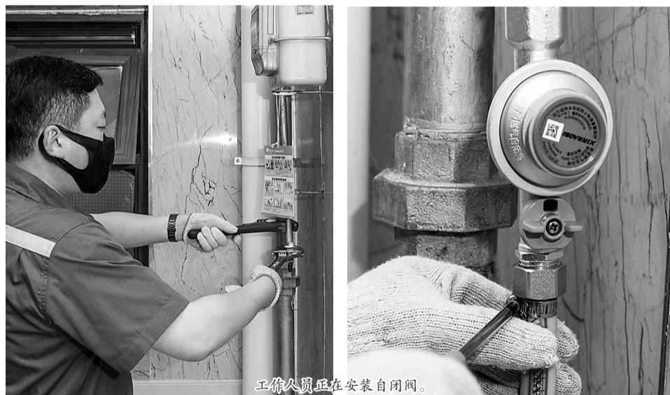
工作人员检测居民家中燃气装置。
