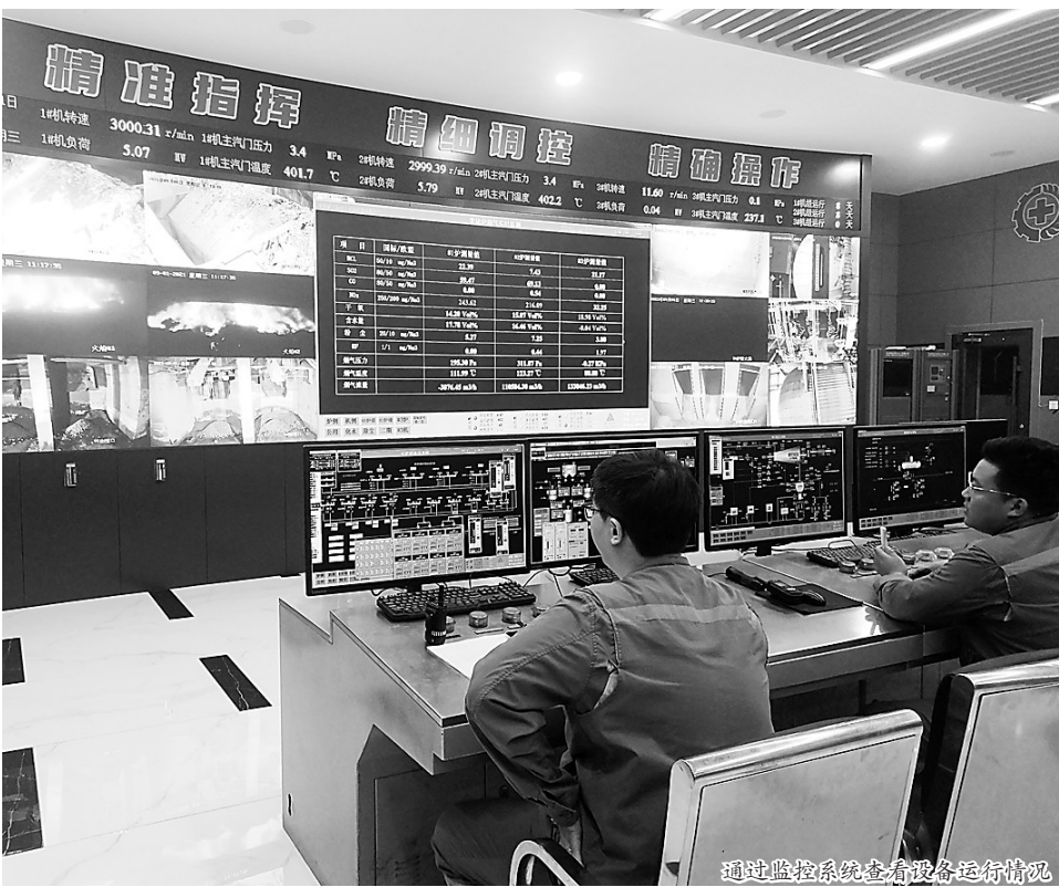
通过监控系统查看设备运行情况
