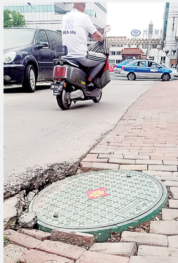
市区新华路沧州饭店东侧小路上,一个井盖损坏翘起了角,存在安全隐患。希望相关部门尽快修复。 张婧 摄
