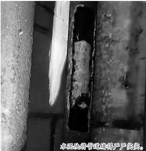
水泥块将管道堵得严严实实。
